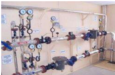
Проектування та монтаж понад 100 вузлів обліку теплової енергії в ЖКГ м. Києва
